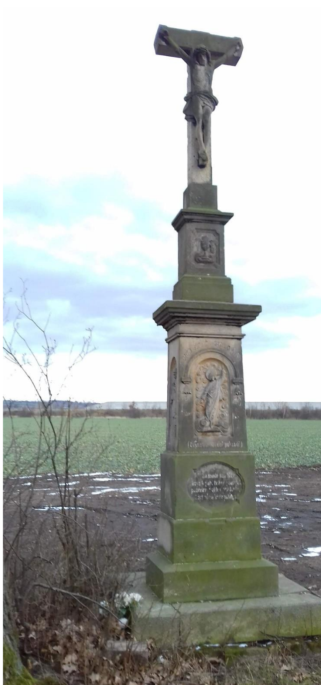
Kříž Na polovicích před opravou
